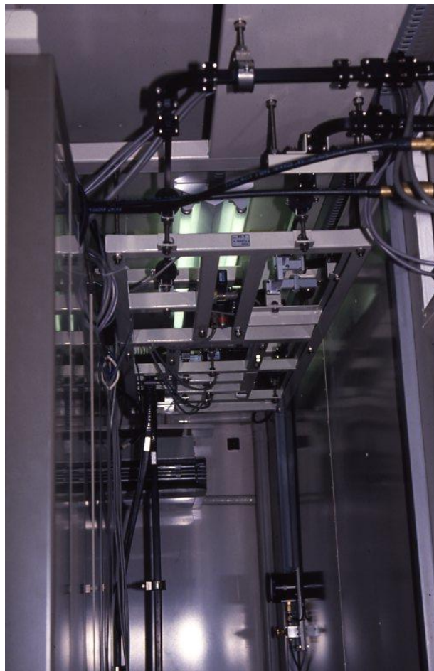
導波管の配線 (上部)
